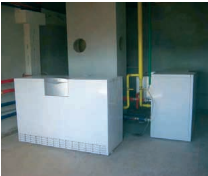
Jedna od kotlarnica u kojoj je ugrađena Vaillantova oprema
