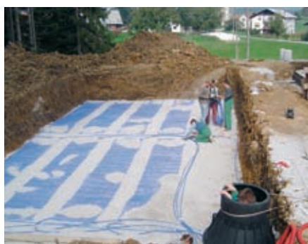
Izgled postavljenih kolektora
