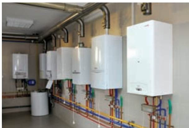
Praktikum školskog centra za obuku partnera za rad na uređajima Vaillanta i Protherma
