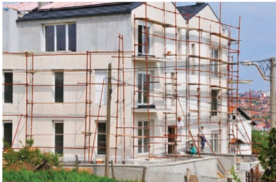
Objekat Amadeo koji će se grejati i hladiti Vaillantovom toplotnom pumpom
