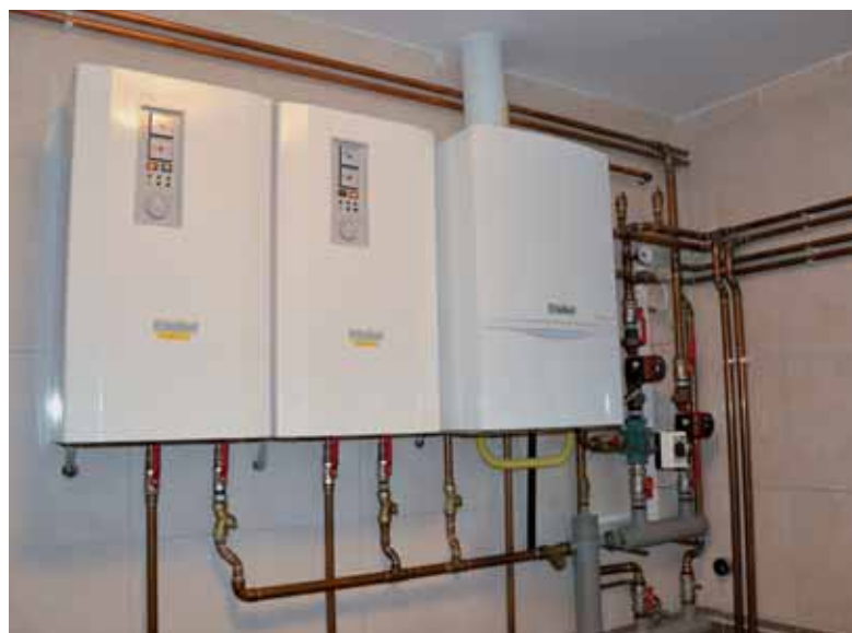
U kotlarnici poslovnog objekta Dunav prevoz
