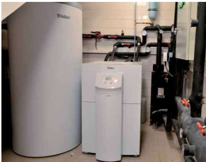
Toplotna pumpa i pufer rezervoar u objektu Amadeo
