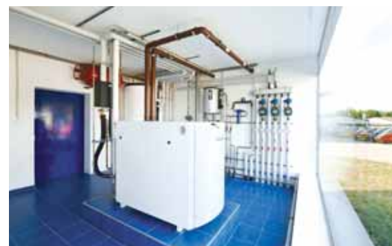
ecoPOWER u centralnoj kotlarnici
