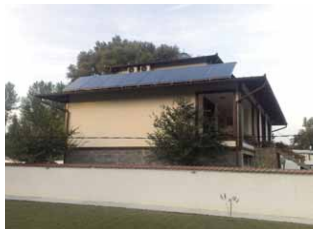
Solarni kolektori na privatnoj kući na Savi
