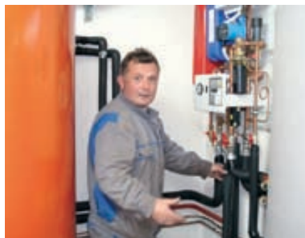
Danit-instalacije d.o.o. sačinjava stručni tim ljudi
