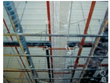
Danit-instalacije posjeduju značajno iskustvo i u izvedbi toplinskih stanica i kotlovnica
