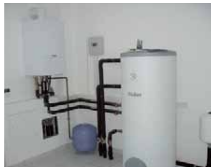
Kondenzacijski uređaji smješteni su u četiri različite kotlovnice
