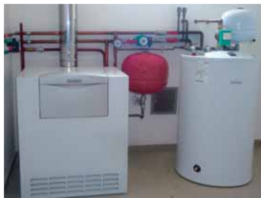
Kotlovnica obiteljske kuće s atmoVIT-om i spremnikom od 120 l
