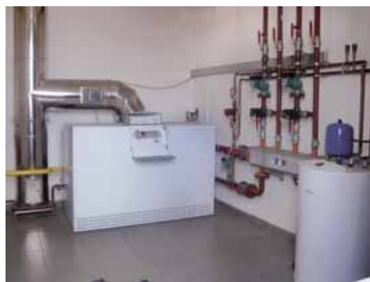
Kotlovnica Zrinski Tehnologije (Varaždin) s atmoCRAFT-om i spremnikom od 120 l
