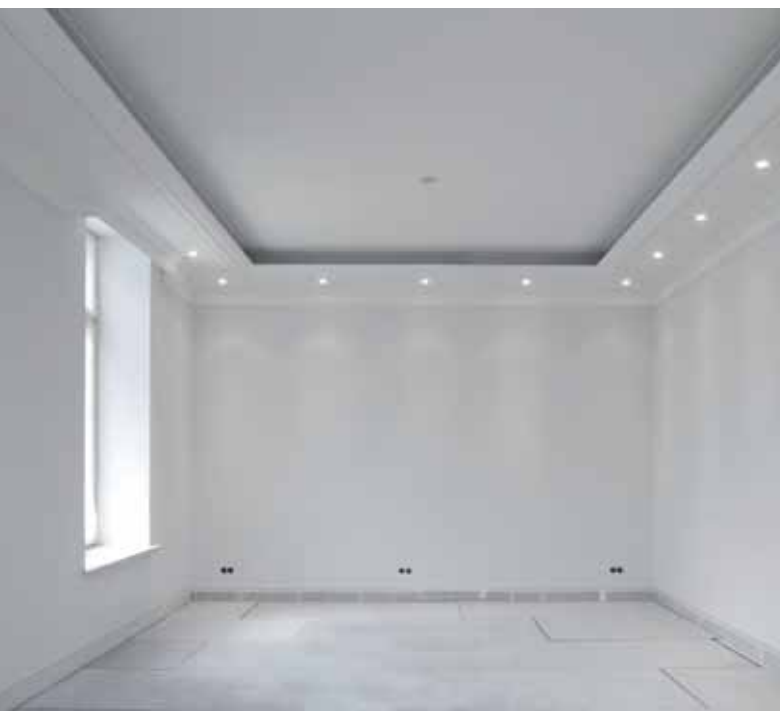
Interijer s ugrađenim svim Knauf sustavima i sustavima plošnog grijanja i hlađenja
