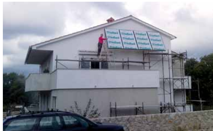
Objekt s Vaillantovim kolektorima u Rasopasnom na otoku Krku
