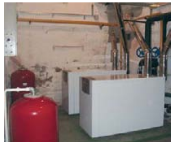
Modernizirana kotlovnica je opremljena s dva ecoCRAFT-a snage 240 kW
