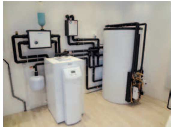
Kotlovnica u Vaillantovoj „kući“.
