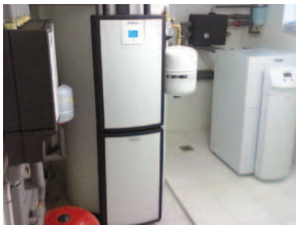
Referentni objekt s ugrađenom dizalicom topline geoTHERm i spremnikom VPS/2
