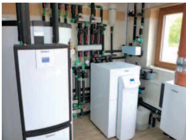
Strojarnica s elementima postrojenja
