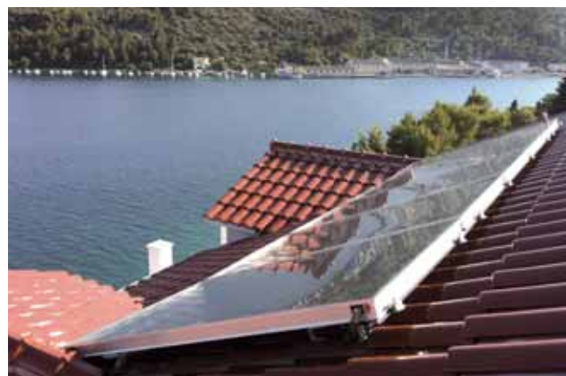
Kolektorsko polje na stambenom objektu Vela Luka (Korčula)
