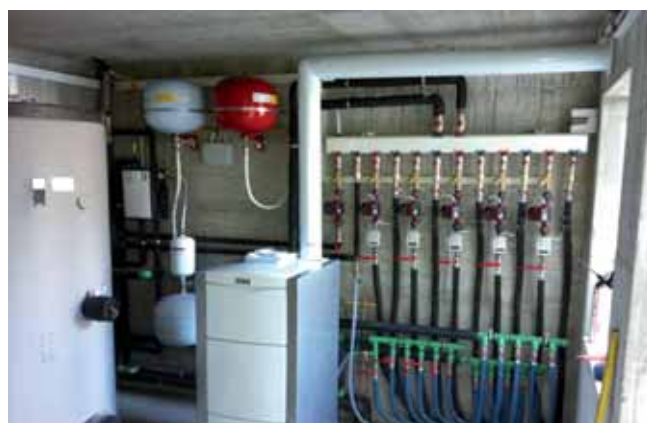
Kotlovnica u stambenom objektu Vela Luka (Korčula)
