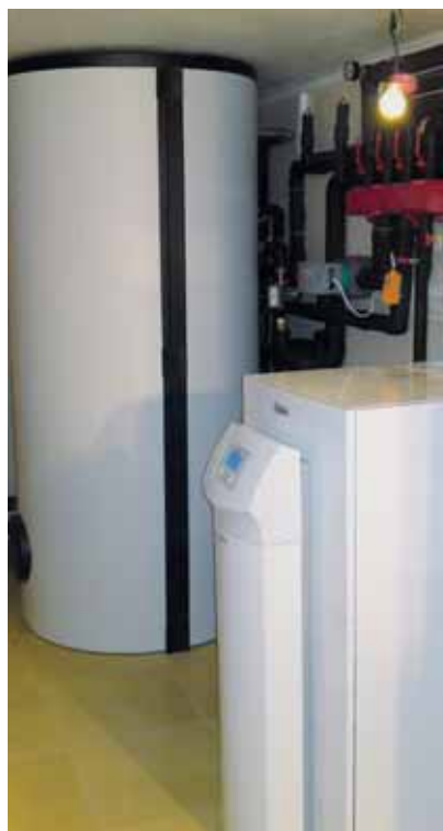
Kombinirani sustav s dizalicom topline geoTHERM VWS i VPA 1000 za pasivno hlađenje - Zagreb, Gornji Bukovac
