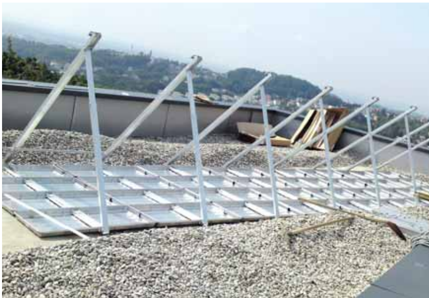
Nosiva konstrukcija za toplovodno solarno kolektorsko polje na ravnom krovu - Zagreb, Šestine
