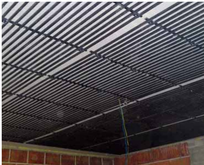
Niskotemperaturno stropno grijanje/hlađenje - Zagreb, Donji Bukovac
