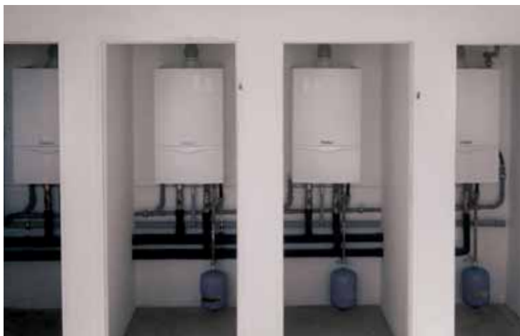
Kaskada sa 4 uređaja ecoTEC plus od 46 kW
