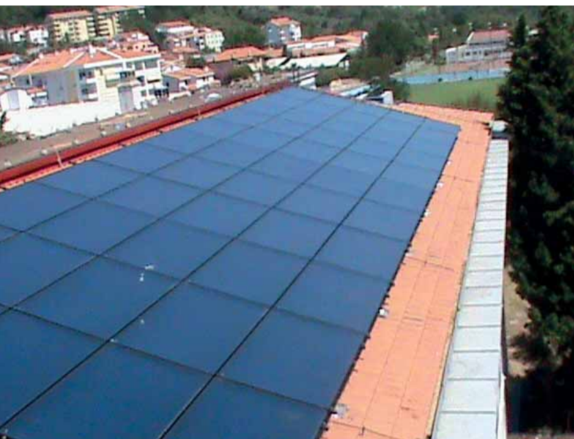
Solarno kolektorsko polje s pločastim kolektorima auro THERM VFK 145 H
